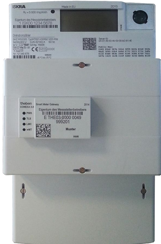
Bild 4: MT63x Zähler mit installiertem Gateway und Moduldeckel
